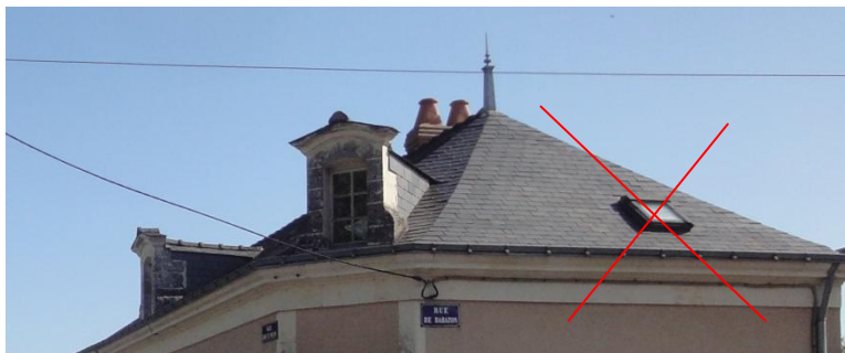
Velux en surépaisseur : dénature l'harmonie de la couverture
